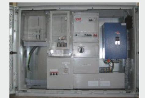
Straßenbeleuchtungsschrank inkl. Dimmer
